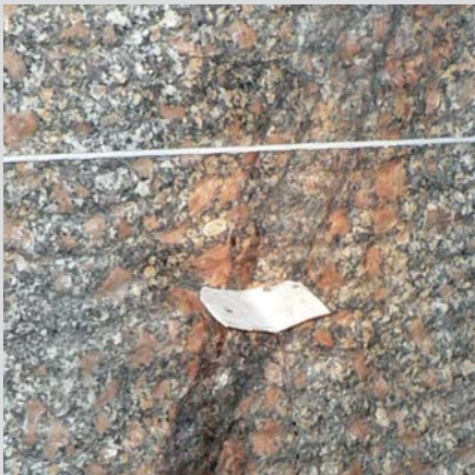
Tunel Bedřichov - odběr podzemních vod na puklině.
