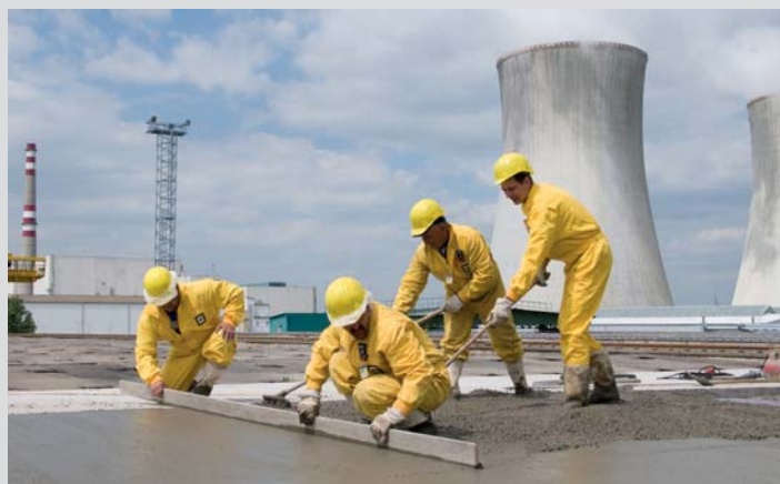
Finalizace dočasné izolace uzavřené jímky (finální překryv úložiště bude proveden před jeho uzavřením).
