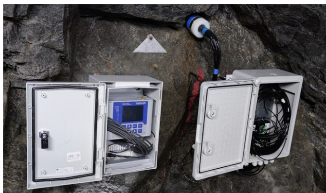
Obr. 26 – Zhlaví monitorovacího vrtu a měřící ústředny
