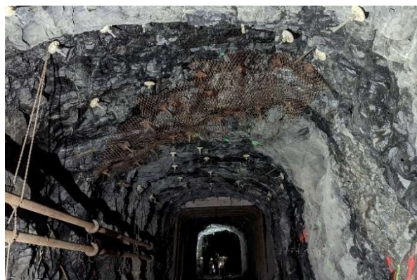
Obr. 17 Průsaky v okolí zlomu SG04 v chodbě L4b – cca 22 až 26 m
