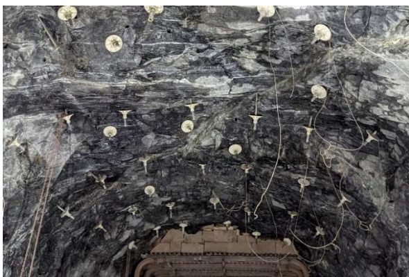
Obr. 16 Intenzivní zvodnění v okolí zlomu SG03 v chodbě L4a – cca 28 až 32 m
